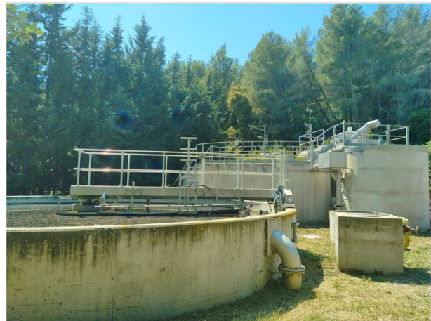
La station d'épuration à Orgon
