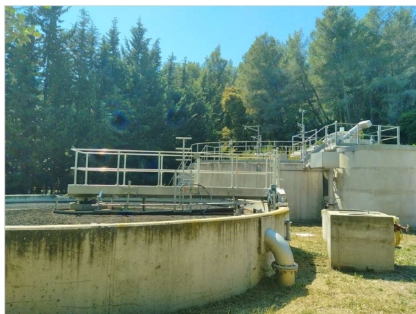
La station d'épuration à Orgon
